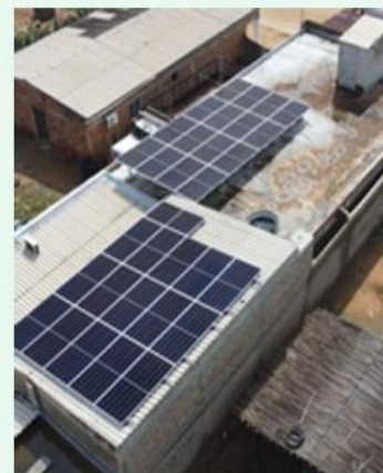
Sistema solar fotovoltaico — Sede Uribia
