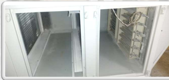
Equipos en malas condiciones, manejadoras y fancoils
