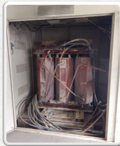
Antiguo transformador averiado por corto circuito en 2023
