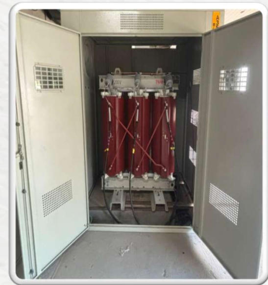
Nuevo transformador adquirido en la vigencia 2024
